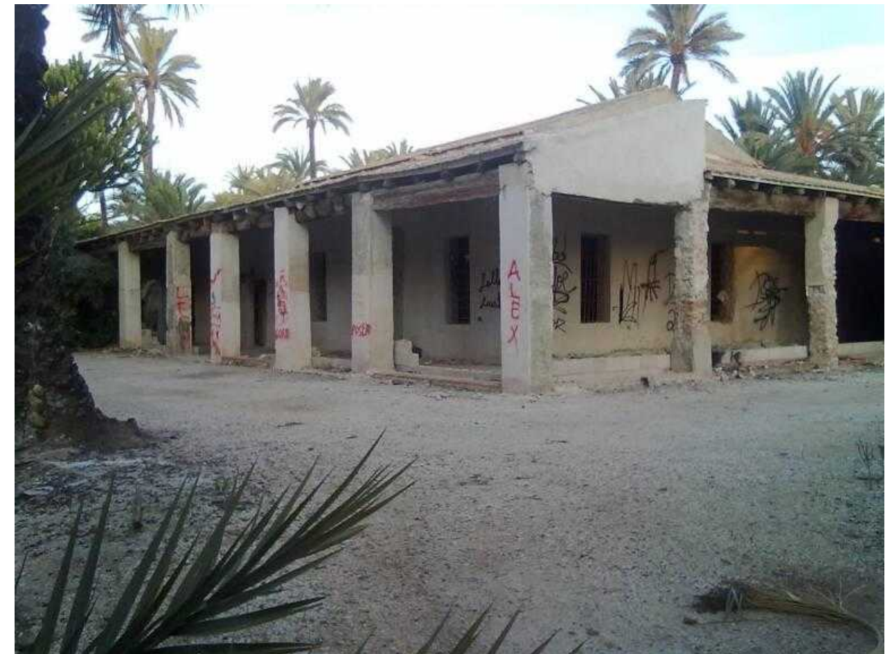
Casa del agricultor del hort dels Pontos que se está restaurando. Fuente: https://alicantepiazza.es/la-casa-del-hort-de-pontos-sera-rehabilitada-para-uso-turistico-asociado-al-camp-del-x
